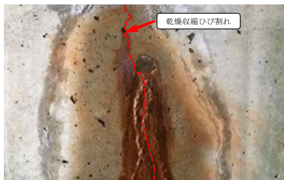
写真-3.1.1 セパレータ箇所に生じた変状
